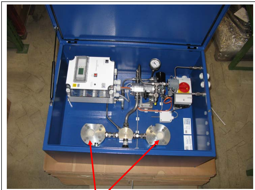
Standard 2 Behälter-Anlage mit SPS und Pumpe
